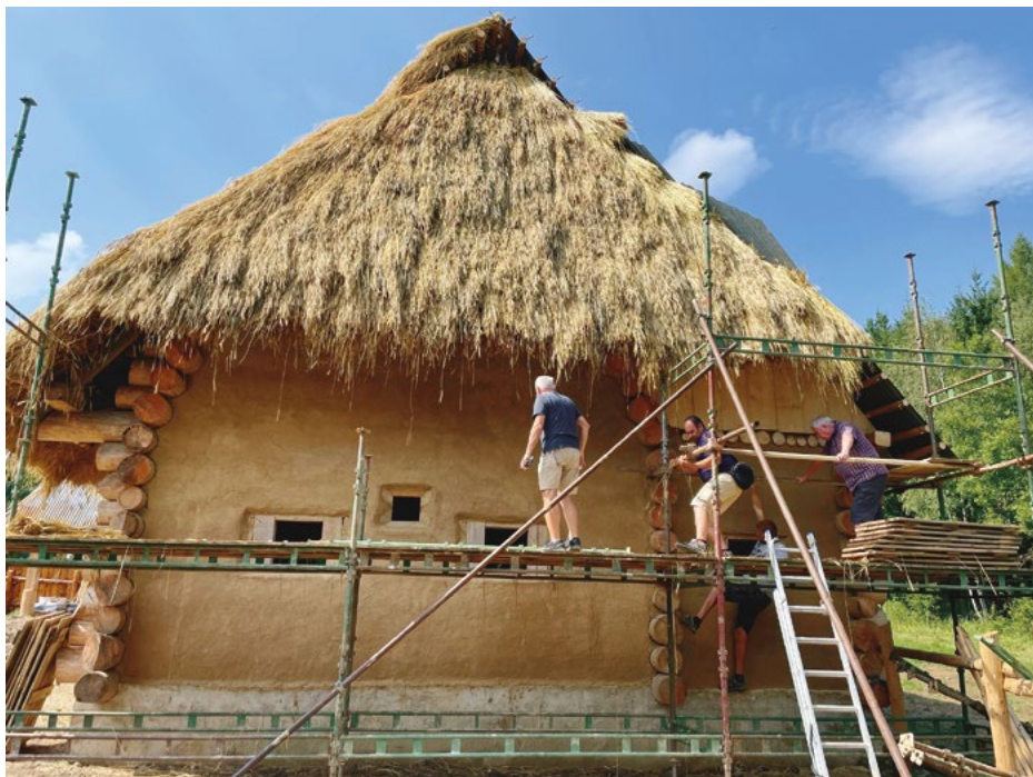
Pokládka doškové střechy domu v usedlosti. Na lešení mj. prof. Jiří Škabrada a arch. Petr Dostál. Foto Ivan Náprstek
