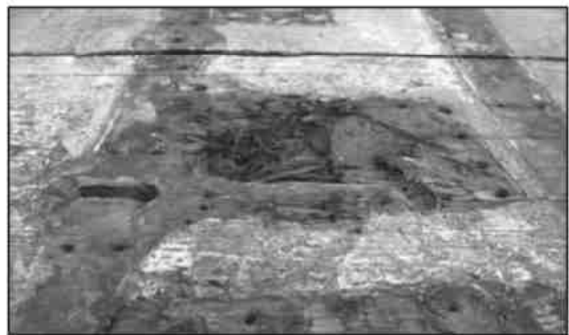
Detail poškození dveří (asi prosekáno sekerou, poté přeplátováno železnou deskou).
