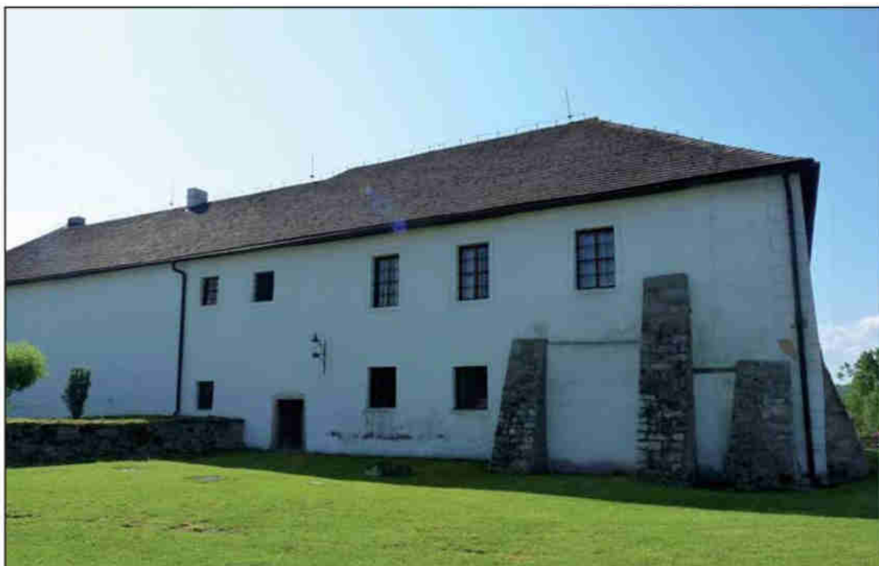
Severozápadní část tvrze před opravou fasády.
