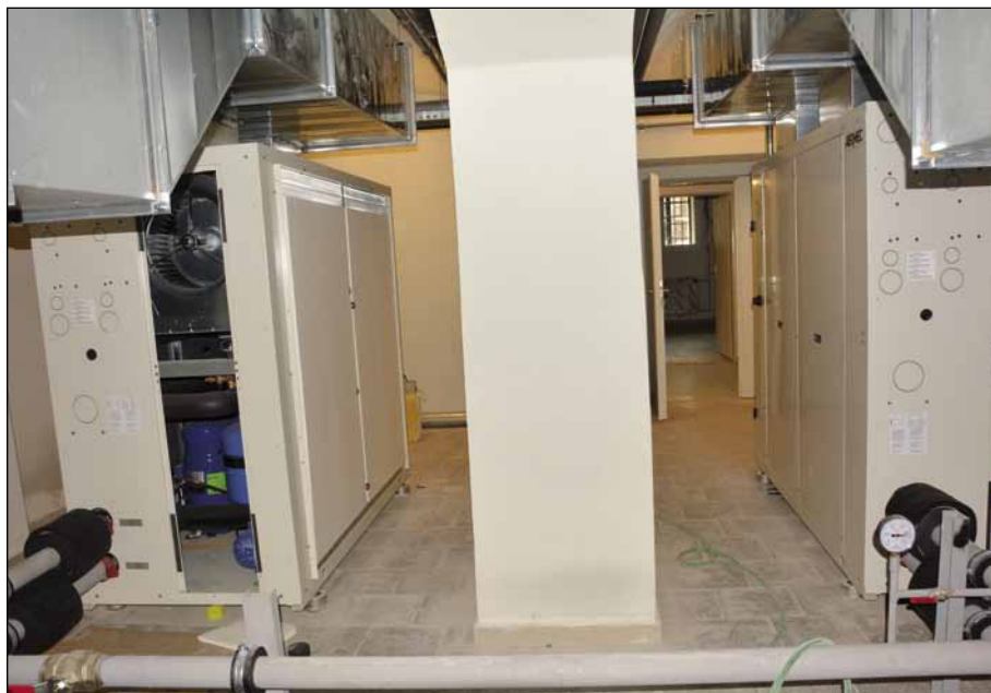
Prostory pro technologická zařízení v suterénu.
