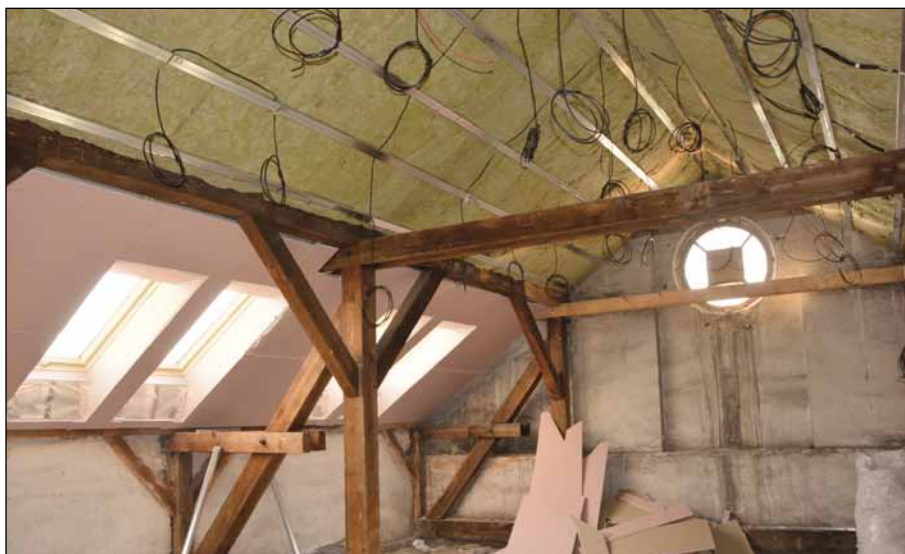
Důležitou součástí projektu rekonstrukce bylo využití půdních prostor budovy. Pohled na zateplování střechy a montáž sádrokartonů. (7. 10. 2013)
