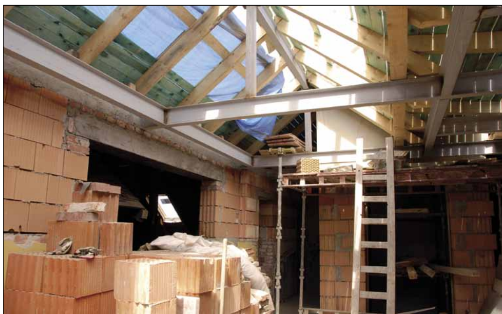
Vestavba vstupního atria 4. NP spojujícího kanceláře půdního prostoru sedlové střechy a vnitřního prostoru kupole. (30. 6. 2013)
